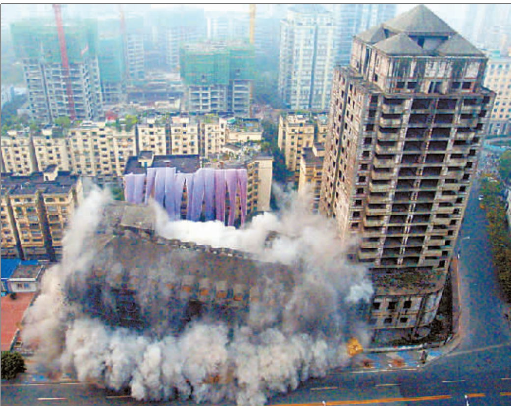
米兰大厦附楼轰然倒塌
