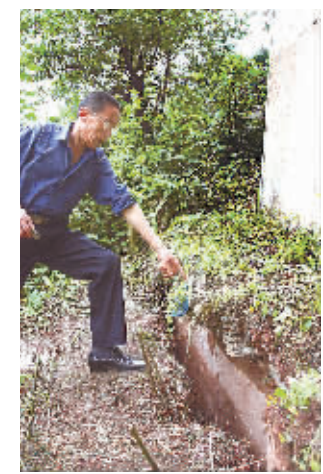
轻轨桥墩下露出约40厘米宽裂缝
