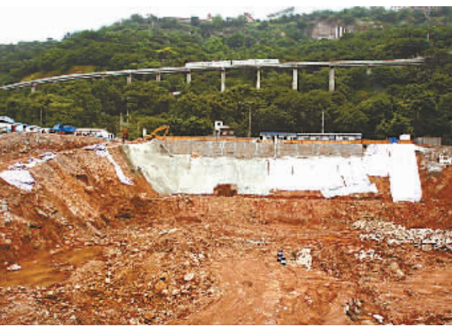
有关部门推测这个工地施工造成轻轨桥墩地面裂缝
