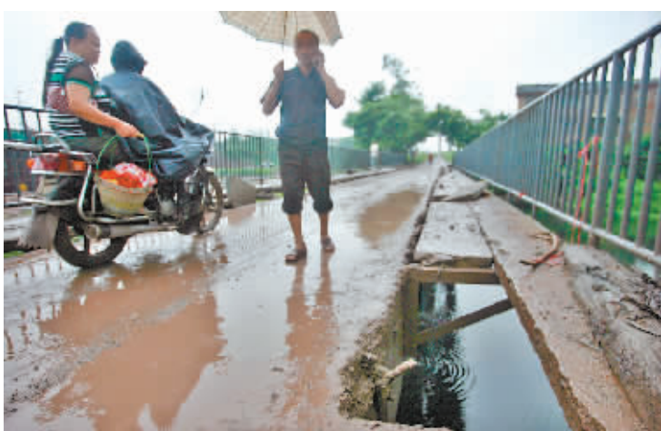
王家桥上人行道路板损坏严重 记者 钱波 实习生 张菊 摄
